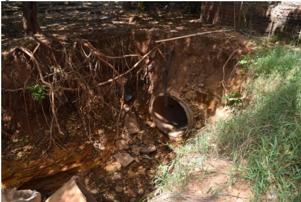
Figura 2 - Erosão - Local do estudo
