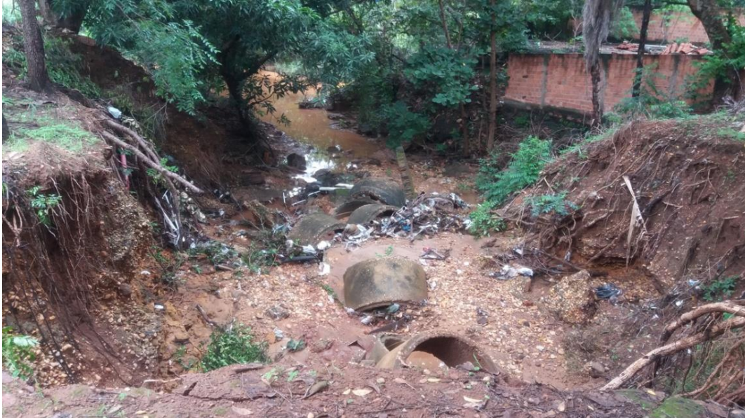
Figura 3 - Erosão - Local do estudo
