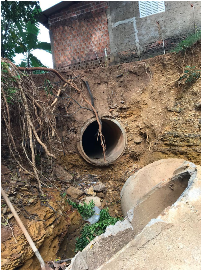
Figura 4 - Erosão - Local do estudo
